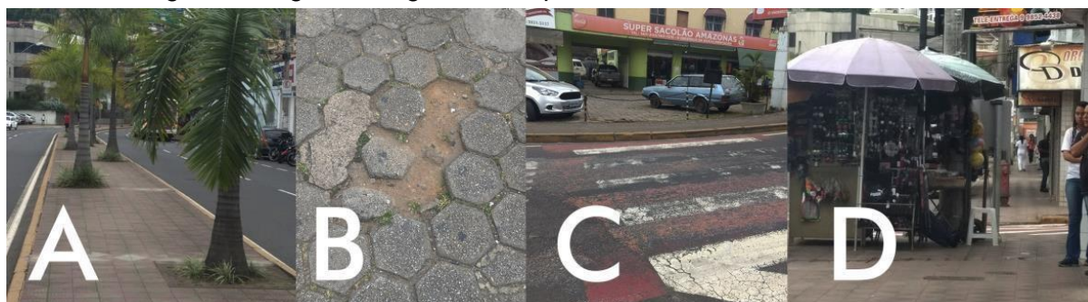
Figura 2: Registro fotográfico dos problemas encontrados na avenida.
