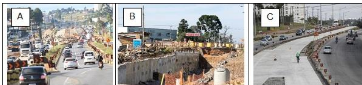
Figura 11: A – BR-476 - construção Passarela. Fonte: Rodolfo Luis Kowalski, (2017). B – Trincheira da rua Amazonas de Souza Azevedo. Fonte: Autores, 2019. C –Pista para o BRT. Fonte: Jonathan Campos/Gazeta do Povo, 2019.
