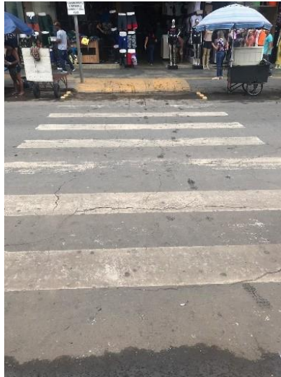
Figura 7: Faixa de pedestre parcialmente apagada.
