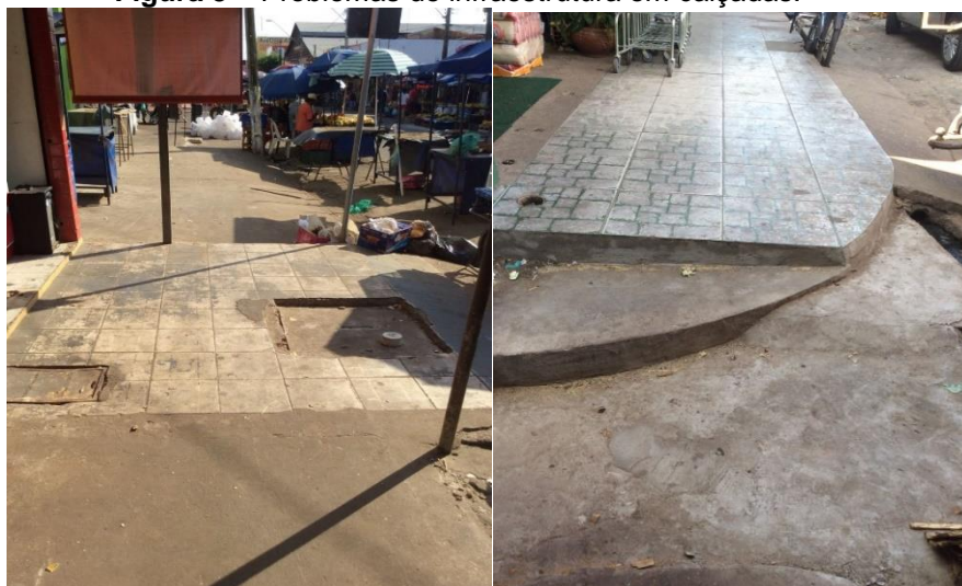
Figura 3 – Problemas de infraestrutura em calçadas.
