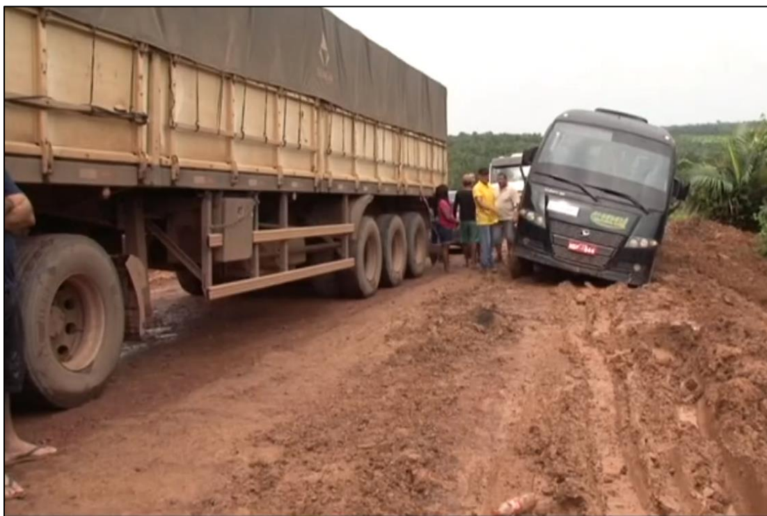
Figura 2: Trecho crítico da rodovia BR-163. (Fonte: G1 Pará)
