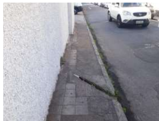
Figura 12 - Calçadas com péssimas condições de conservação (Rua Afonso Pena) - Fonte: próprio autor.
