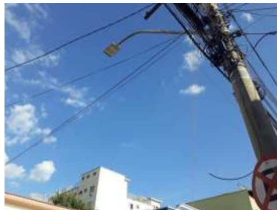
Figura 10 - Detalhe da iluminação e sinalização na Rua Dom Nery - Fonte: próprio autor.
