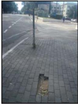
Figura 8 Calçada danificada e pisos faltantes
