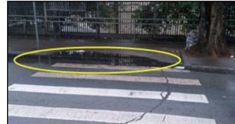
Figura 10 Faixa de pedestre com poça de água
