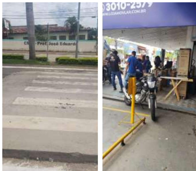
Figura 9 – Rampas para acessibilidade universal inadequadas
