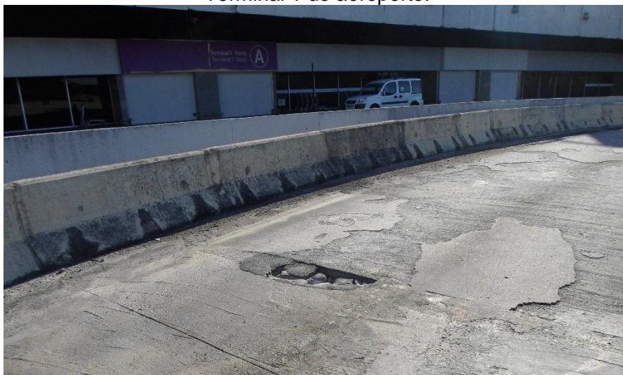
Figura 3 – Buraco na via em frente à estação Galeão (Tom Jobim I) que fica próximo ao Terminal 1 do aeroporto.
