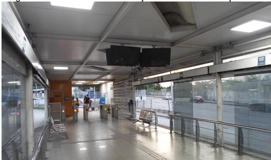
Figura 12 – Monitores de informação avariados na estação Maré.
