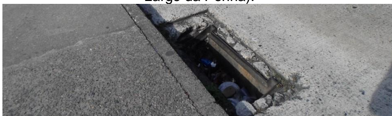
Figura 1 – Buraco na via sentido Galeão em frente a estação Penha II (Trecho próximo ao Largo da Penha).
